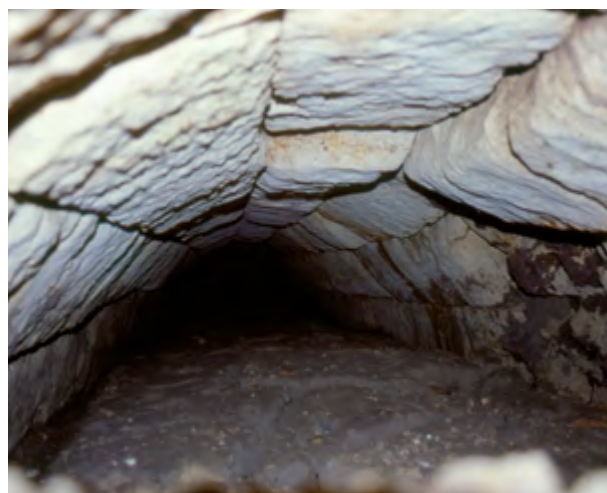
Figura 21. Detall interior de la coberta del gran col·lector documentat a la calçada del carrer d'Apodaca, a l'altura del núm. 4. Arxiu: CODEX
