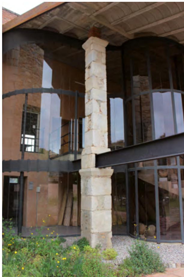
Figura 15. Aspecte actual del pilar que havia de sustentar la secció conservada de la casa forta vora la torre.
