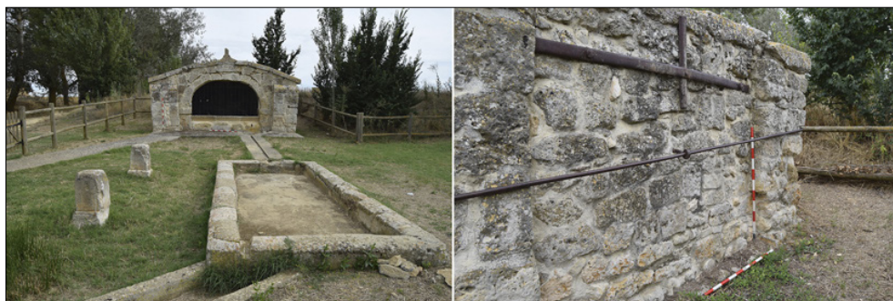
Figura 9. A la izquierda puede observarse una vista general de la Fuente de la Villa de Guaza de Campos. A la derecha puede observarse un detalle de uno de sus laterales con un refuerzo metálico.
